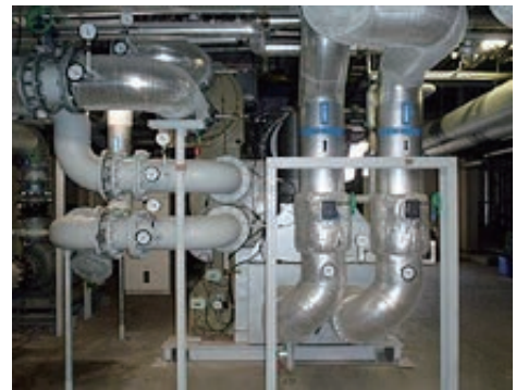
Turbo refrigerator (Kagoshima Sendai Plant)
